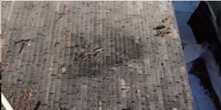
腐朽菌の影響で屋根が腐食
