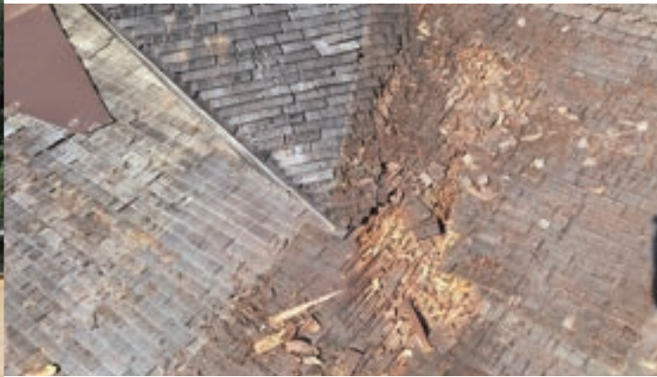
雨水の通り道となる谷の部分で腐食しやすい箇所
